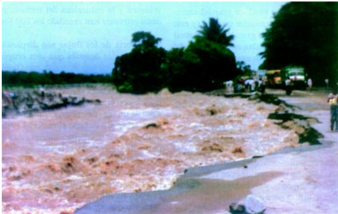
Brazo del río Samalá que destruyó un tramo de 40 metros de la carretera CA-2, Km. 176.5, puente El Niño. (Lahar categoría 4, del 28 de agosto de 1993) La fractura llegó hasta la línea media de la carretera
